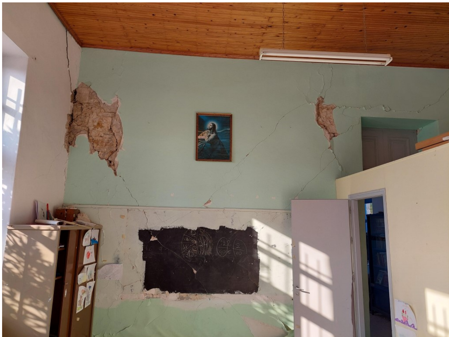
Διατμητικές βλάβες στη λιθοδομή στο Δημοτικό Σχολείο Κοντακαίκων
