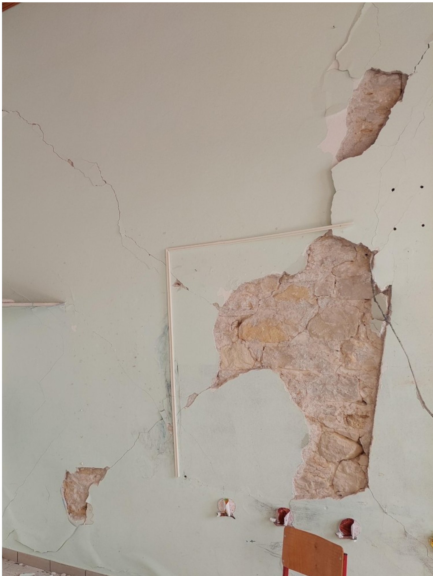
Κατακόρυφη ρωγμή στη λιθοδομή στο Δημοτικό Σχολείο Κοντακαίκων. Διακρίνεται το άοπλο οριζόντιο διάζωμα στη στέψη της τοιχοποιίας κάτω από τη στέγη. Διατηρητική βλάβη.
