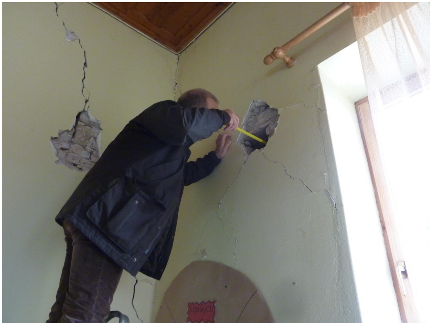
Διατμητικές βλάβες στο Δημοτικό σχολείο στον Πλάτανο Σάμου, εξέταση του τρόπου δόμησης της λιθοδομής
